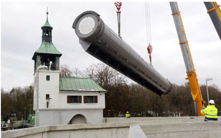
Für die technische Erneuerung des Hochablasses 2018 wurde auch ein neues Walzenwehr eingebaut, das der Energieversorgung dient. Aus Gründen des Denkmalschutzes sieht es aus, wie das Vorgängermodell aus dem Jahr 2011.
